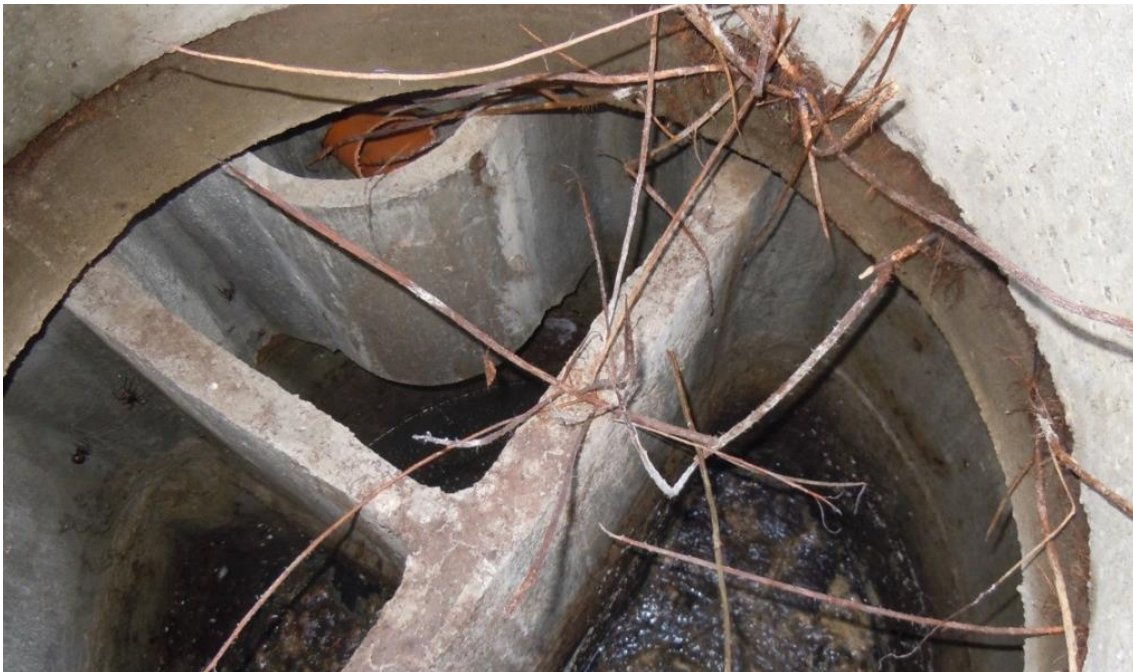
Otät slamavskiljare, risk för in- och utläckage av avloppsvatten och igensättning av efterföljande reningssteg.
