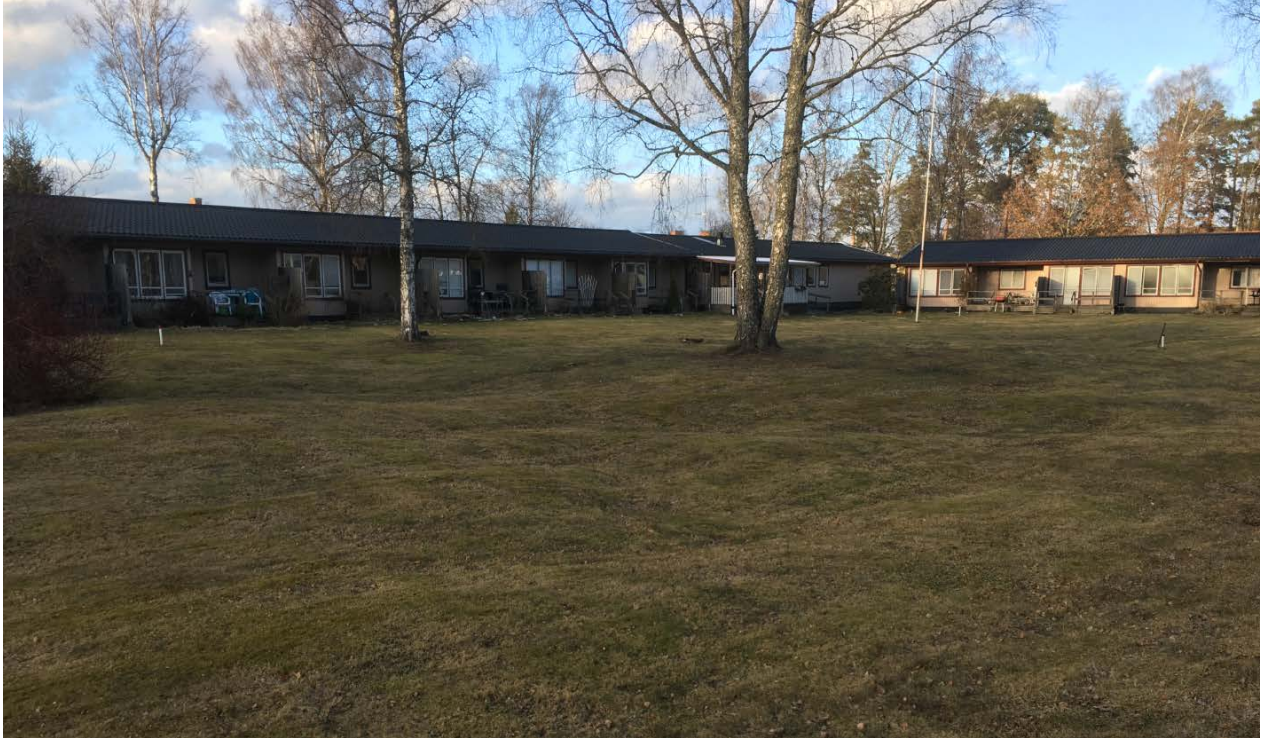
Vildvinet med sättningar i gräsplanen. Tre provtagningspunkter kan ses i form av uppstickande vita rör.
