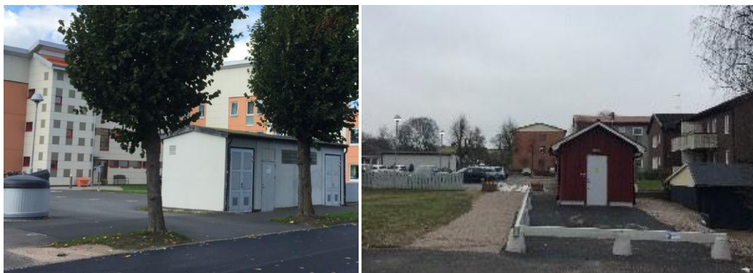
Figur 29: Bilderna visar transformatorstationen inom Falken 10 (sett från Norra Bollgatan) samt tekniskanläggningen inom del av Falken 15, på bild åt höger
